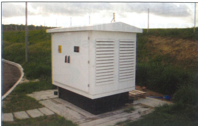
Slika 1: Kompaktna transformatorska postaja
